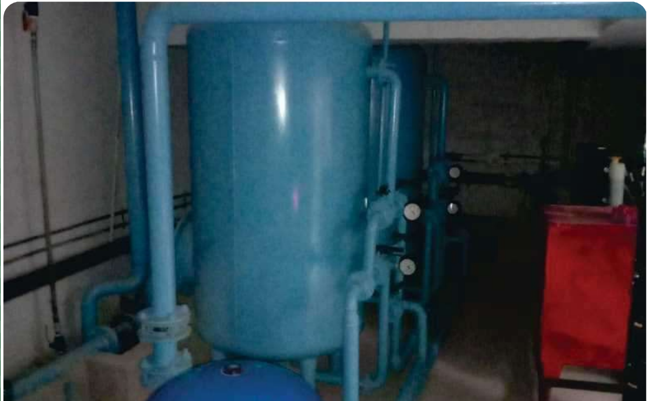
ORO ELEMENTS WTP
